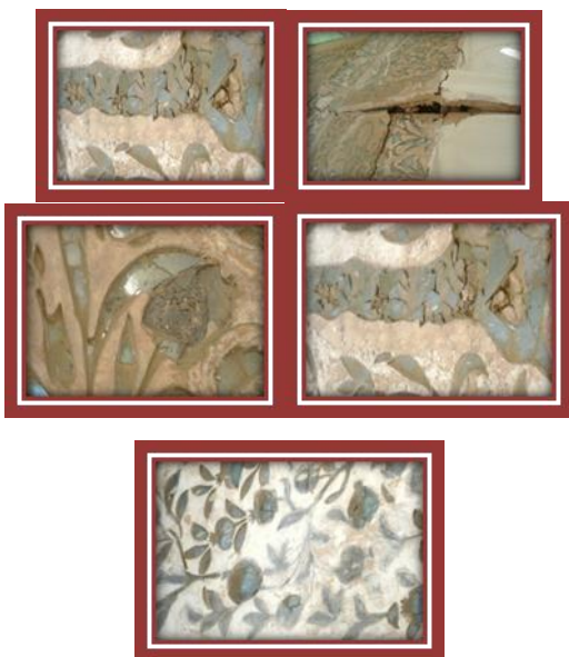
تصاویر ۶۷-۶۳. انواع آسیب‌های کُپ‌بری ریختگی بستروآستر، آسیب سازه‌ای، ریختگی بستر، ریختگی آئینه، مدرسه رودابه، اصفهان
